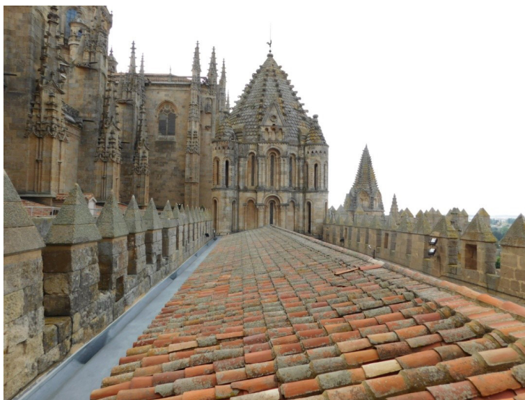
Fig. 7: Cubierta exterior y parapeto almenado de la nave central © Ilmo. Catedral de Salamanca.
