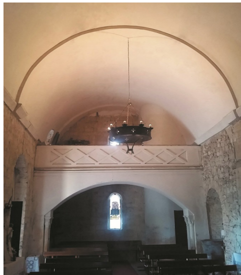
Figura 11. Estado actual del coro y bóveda tabicada de la iglesia. Elaboración del autor.
