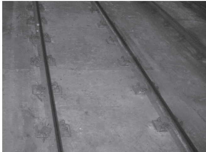
Fig. 2. Vía sobre placa con fijaciones DFF. Línea 3 del Ferrocarril Metropolitano de Barcelona.
