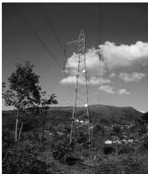
Fig. 12. Estação climatológica com os demais sensores instalados na mesma estrutura 138 kV.
