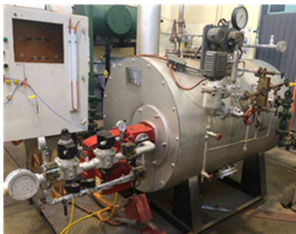
Fig. 1. Caldera a gas en Laboratorio de Termofluidos.
