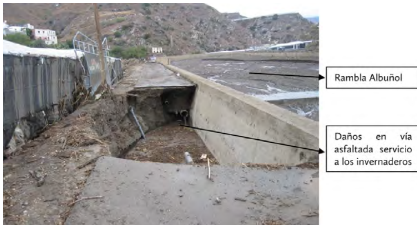
IMAGEN NÚMERO 16.- DAÑOS EN INFRAESTRUCTURAS HIDRÁULICAS. Autor: José Ramón Sánchez Holgado.
