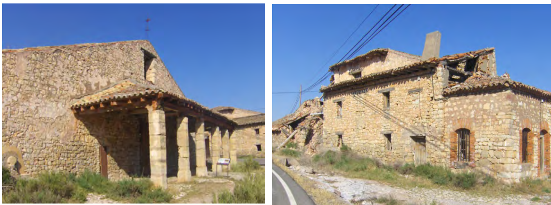
ESTADO DE RUINA DE LAS CONSTRUCCIONES DE LAS SALINAS DE IMÓN.
