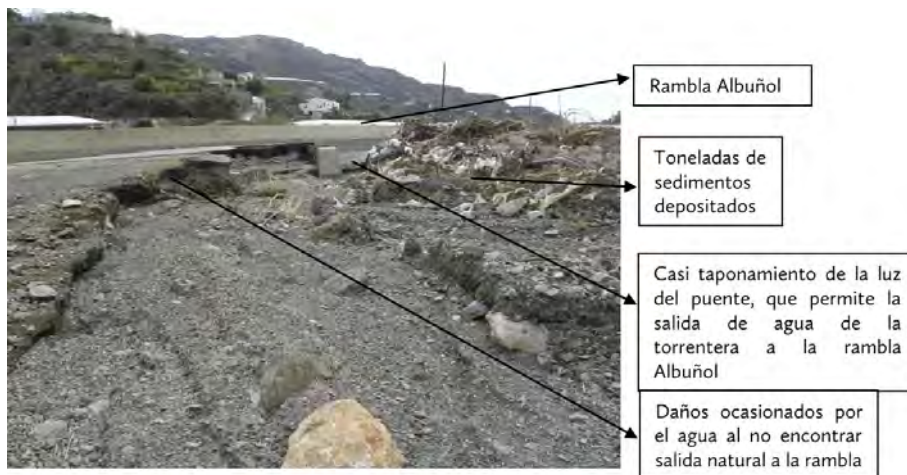
IMAGEN NÚMERO 7.- LOS SEDIMENTOS ARRASTRADOS EN UNA DE LAS RAMBLAS DE DESAGÜE A LA RAMBLA ALBUÑOL, LLEGARON A TAPONAR PARCIALMENTE LA CANALIZACIÓN DE ACCESO QUE SALVA LA VÍA ASFALTADA DE SERVICIO A LOS INVERNADEROS, DESVIANDO SU CAUCE Y PRODUCIENDO LA INUTILIZACIÓN POR DAÑOS DE LA MENCIONADA VÍA. Autor: José Ramón Sánchez Holgado.
