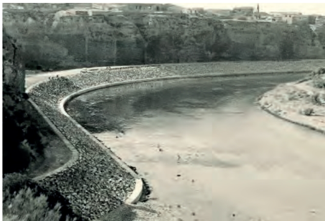
FIGURA 9. OBRAS DEL DESVÍO DEL CAUCE DEL GÁLLEGO BAJO SAN MATEO DE GÁLLEGO. AÑO 1985. Foto: Archivo familiar J. Mondourrey.
