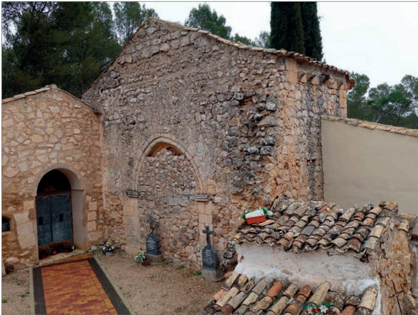
FIGURA 5. RESTOS CONSERVADOS DE LA IGLESIA DE NUESTRA SEÑORA, INTEGRADOS EN EL ACTUAL CEMENTERIO DE LA LOCALIDAD DE ALARCÓN. PUEDE OBSERVARSE EL ARCO DE LA PUERTA ORIGINAL QUE ESTARÍA EMPLAZADO EN EL MURO SUR DEL EDIFICIO.
