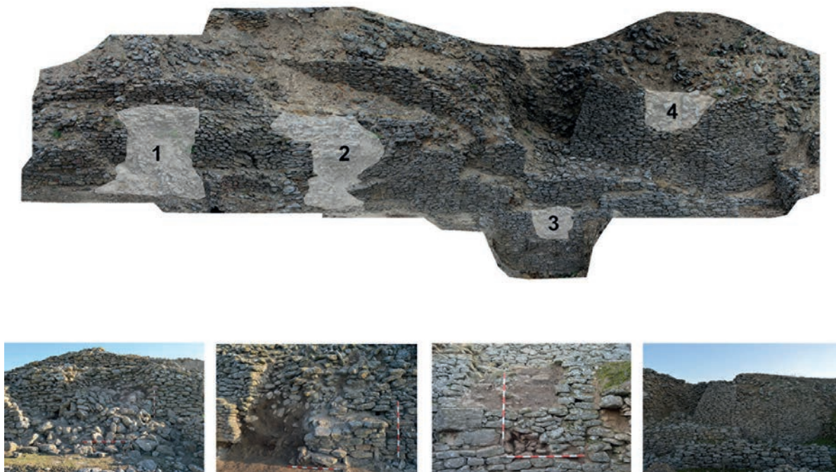
FIGURA 9. SOBRE ORTOFOTO DEL FRENTE OESTE DE LA ACRÓPOLIS, LOCALIZACIÓN DE LAS ZONAS DERRUMBADAS EN LOS CAJONES 2 (DERRUMBE 4), 8 (DERRUMBE 3), 9 (DERRUMBE 2) Y 15 (DERRUMBE 1). ABAJO FOTOGRAFÍA DE CADA DERRUMBE BAJO SU SEÑALIZACIÓN EN LA ORTOFOTO. © J. D. Borrego (2018, fig. 11)
